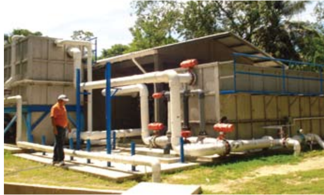
Planta potabilizadora en el sistema Piedras Gordas.
