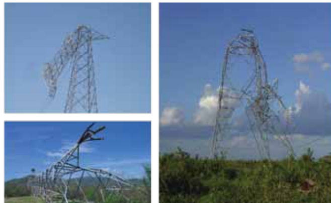
Fig. 1. Daño en el soporte de las torres de una línea de transmisión de la CFE
