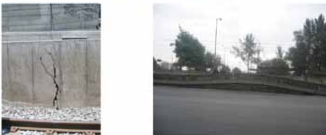
Afectación del hundimiento a la línea A del Metro (López-Acosta et al., 2009).
