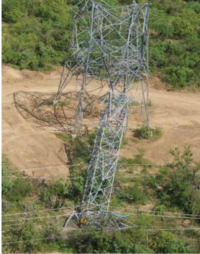
Figura 3. Daños en una torre de transmisión metálica.
