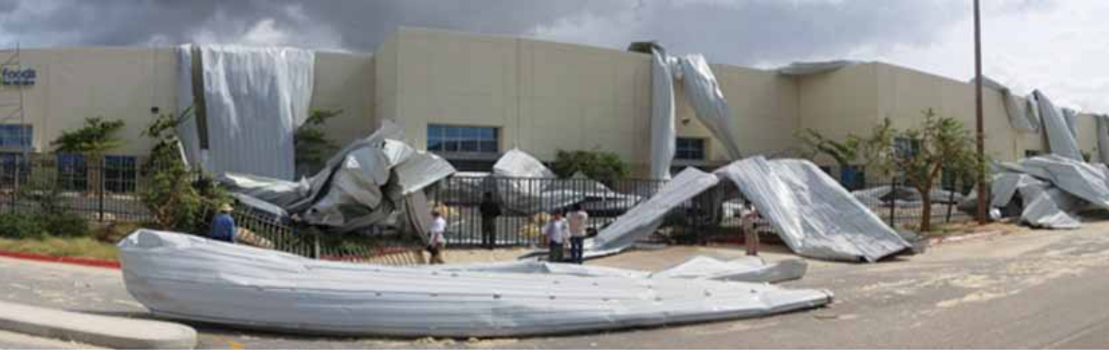
Figura 6. Daño en una nave industrial.
