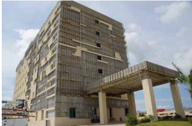
Figura 5. Daño en fachadas de un edificio.
