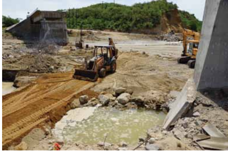
Figura 4. Colapso del puente Caduaño.
