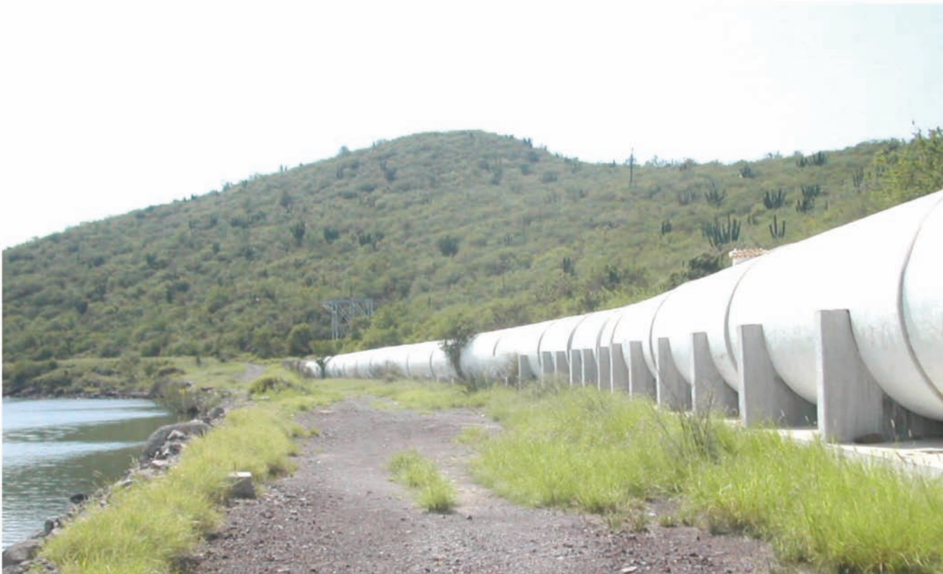
Fotografía de las líneas de 99" del tramo a gravedad que acumularon aire en su interior
