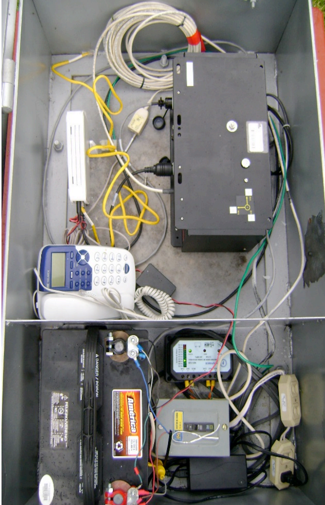
Figura 3. Acelerógrafo, modem, batería, regulador y cargador de batería
