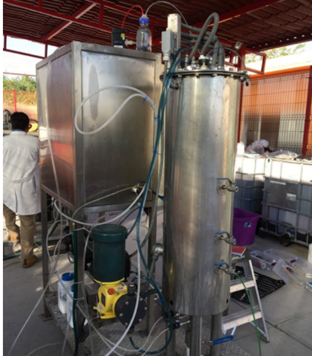
Figura 2. Reactor productor de hidrógeno a partir de efluentes vitivinícolas a escala piloto
