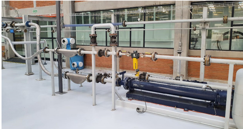
Fig. 1. Zona de máquinas del sistema experimental
