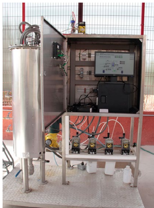
Figura 5. Reactor piloto de 100 L operado como filtro percolador para la producción continua de \text{H}_2
