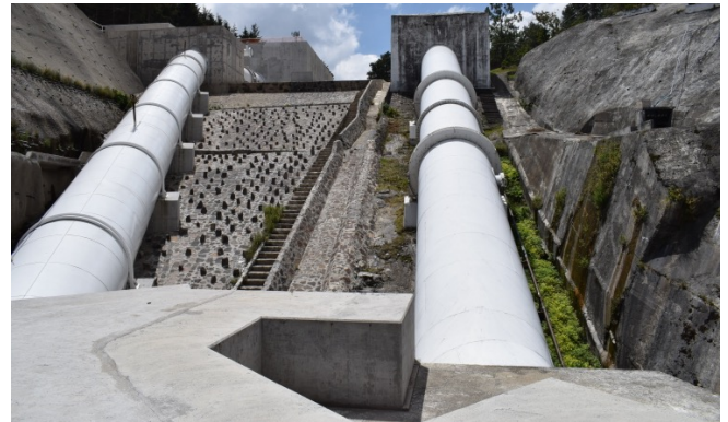
Figura 1. Tuberías de alta presión en la descarga de la Planta de Bombeo No. 5
