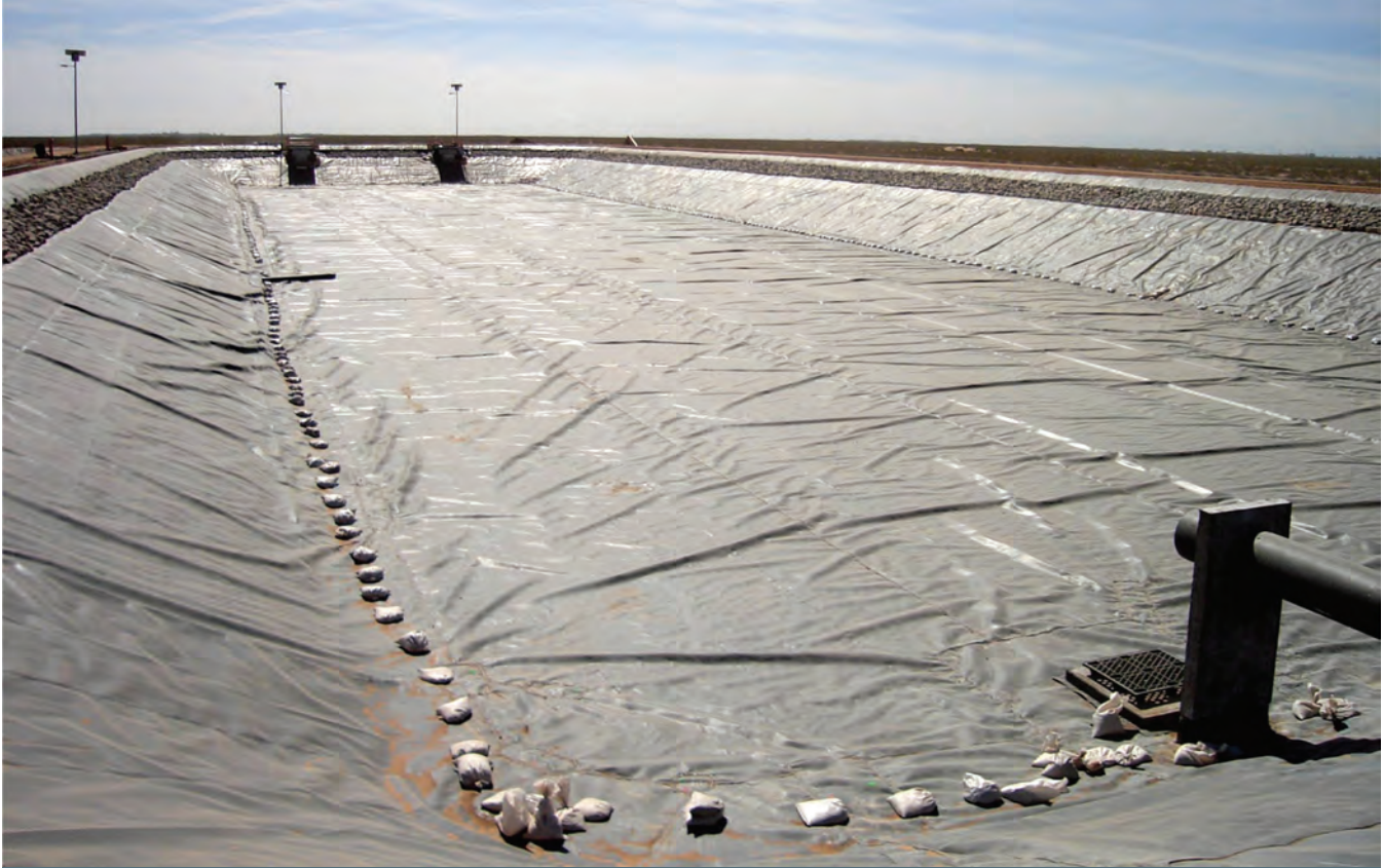
Laguna anaerobia con plantilla de geomembrana de la planta de aguas residuales, en San Luis Río Colorado, Sonora
