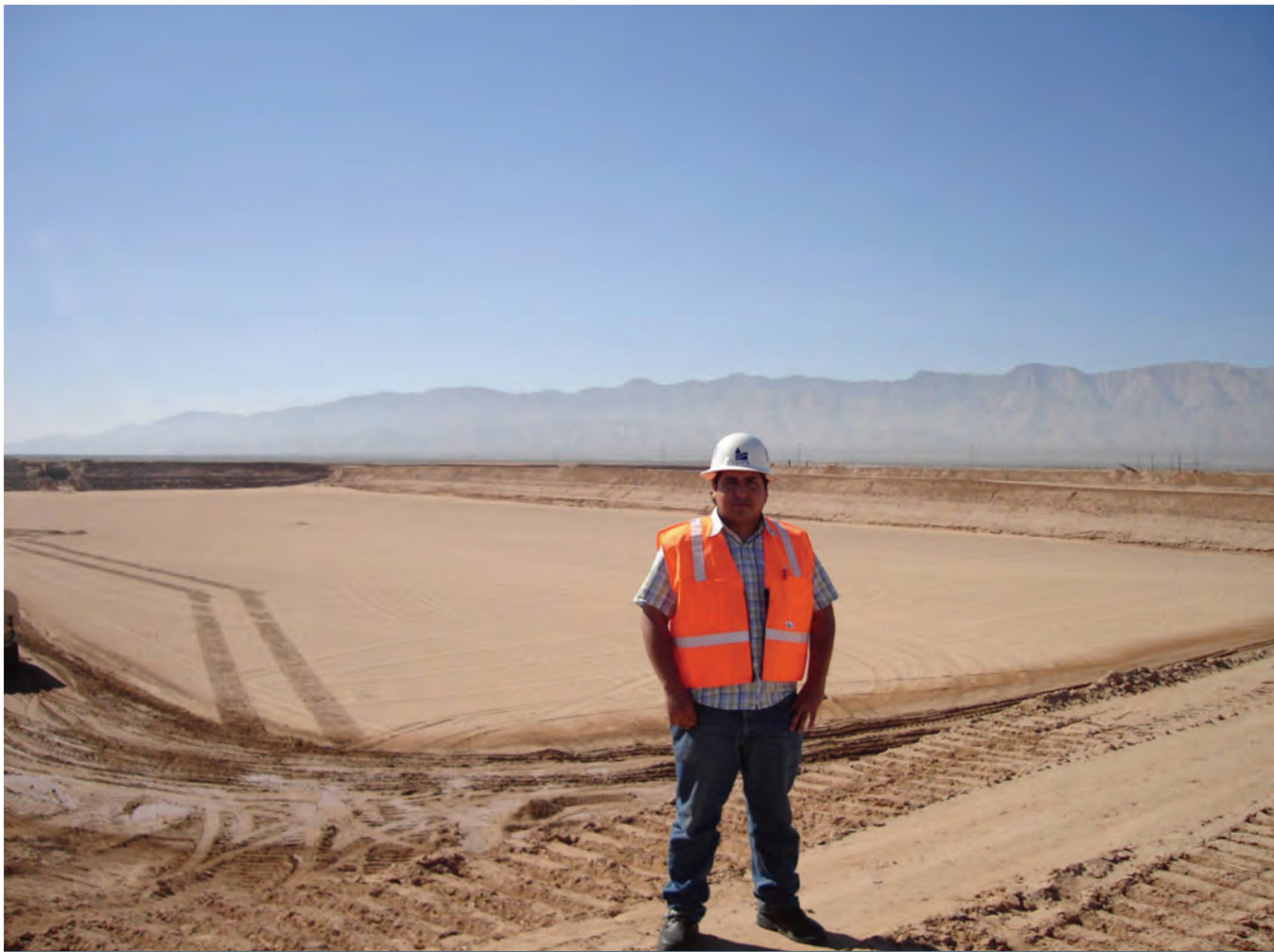
Laguna de aireación en la planta de tratamiento de aguas residuales Mexicali 2
