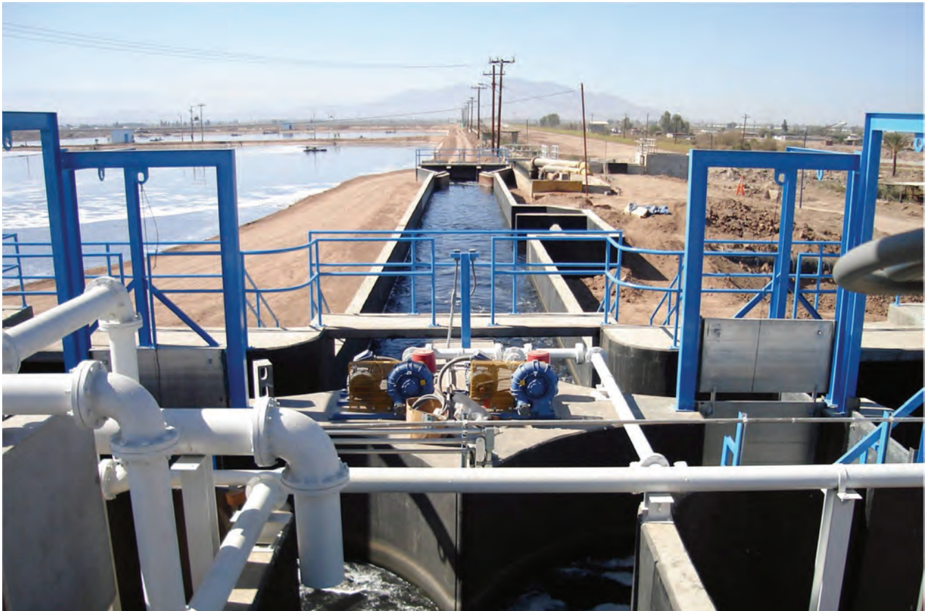
Canal de llegada a la planta de tratamiento de aguas residuales, en Mexicali, Baja California
