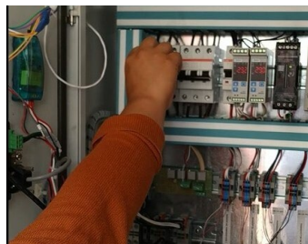
g) Arranque del circuito interno de funcionamiento
