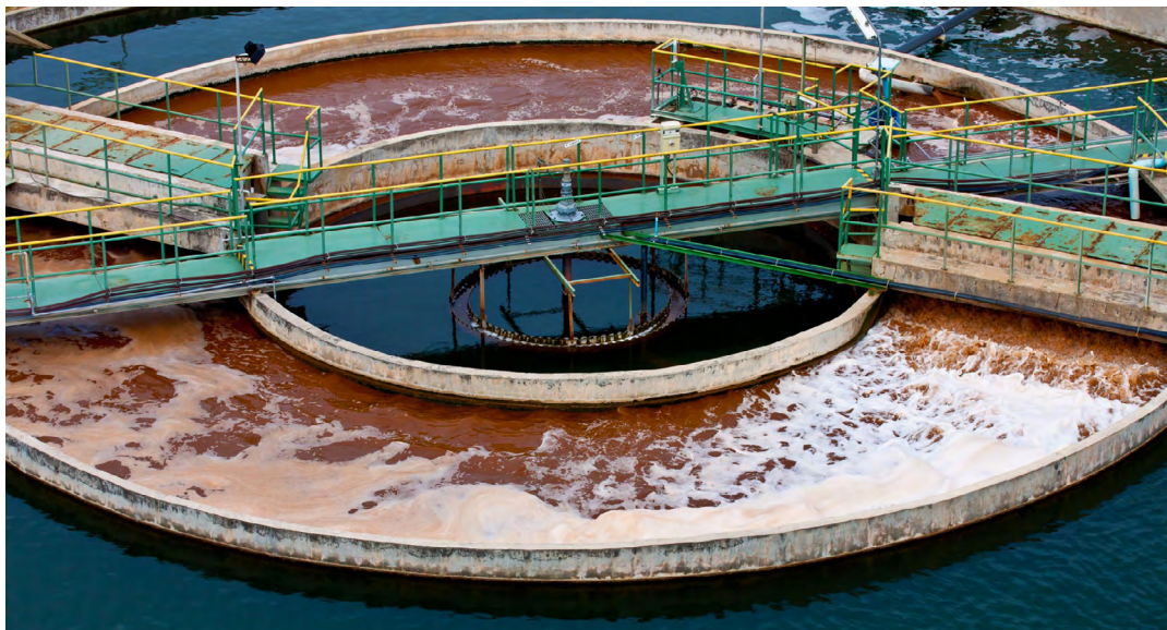
Figura 1. Planta de tratamiento de agua
