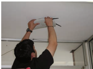
Instalación de puntos de acceso inalámbrico
