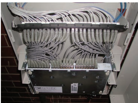
Red de cableado estructurado
