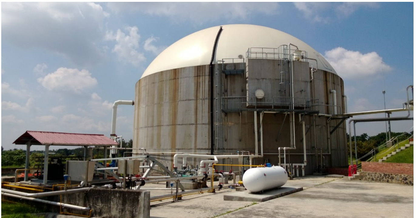
Figura 2. Digestor anaerobio de la planta de tratamiento de agua residual, Acapatzingo, Morelos
