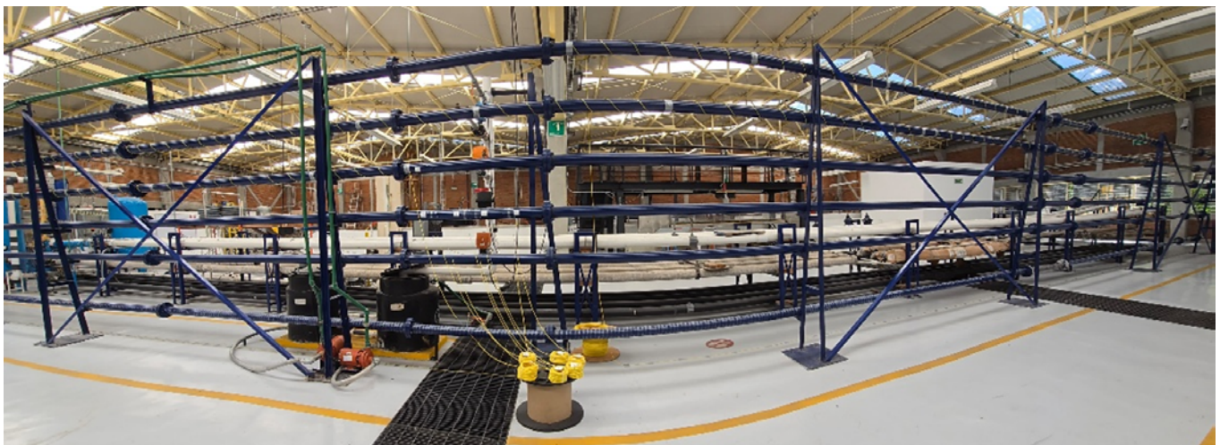
Figura 1. Ducto hidráulico piloto con fibra óptica enrollada alrededor de una sección
