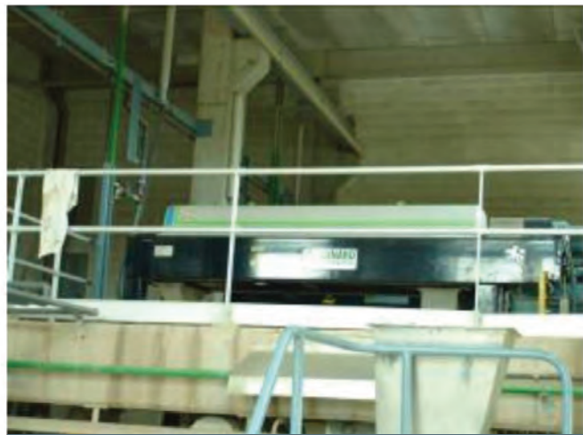
Detalle de centrifugadora y de dosificador de polímero para espesamiento y deshidratación
