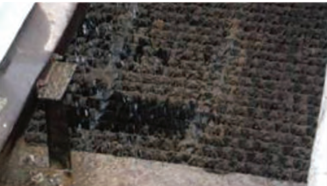
Lodo depositado en las placas del sedimentador
