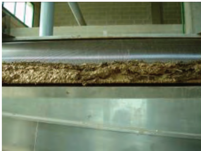
Tamizado de lodos espesados antes de su envío a deshidratación
