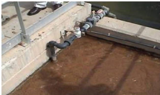
Floculación de lodos purgados de sedimentadores Segunda etapa de espesamiento
