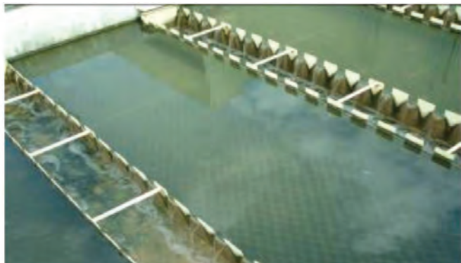
Clarificación de lodos purgados de sedimentadores Tercera etapa de espesamiento
