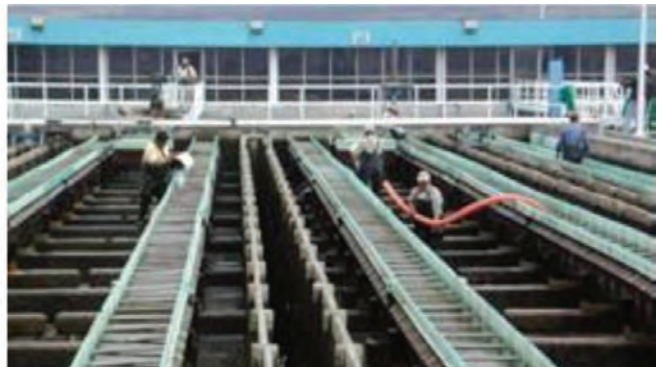
Lavado hidráulico (mangueras y botes) del sedimentador
