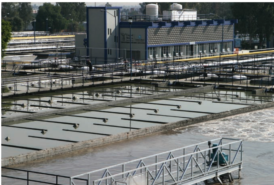
Planta de tratamiento de aguas residuales en la ciudad de México
