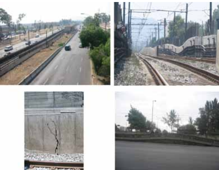
Afectación del hundimiento a la línea A del Metro (López-Acosta et al., 2009).
