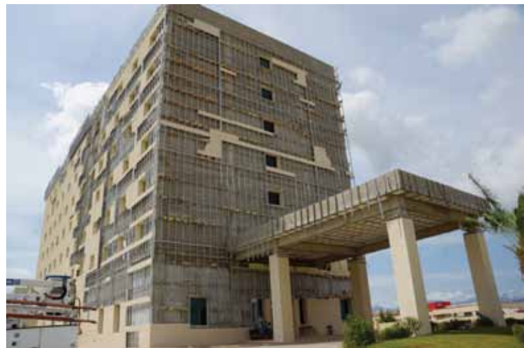
Figura 5. Daño en fachadas de un edificio.
