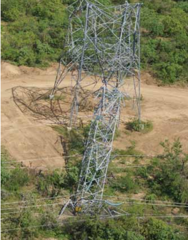
Figura 3. Daños en una torre de transmisión metálica.
