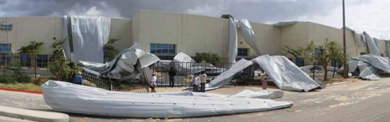
Figura 6. Daño en una nave industrial.
