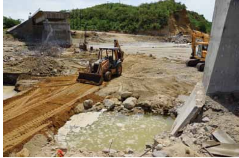
Figura 4. Colapso del puente Caduaño.
