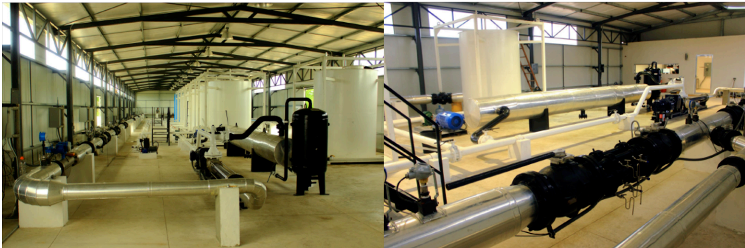
Figura 2. Circuito de 8" con tanques, bomba de cavidades progresivas, cambiador de calor y sección de toma de muestras compuesta por un haz de siete tubos de 1"
