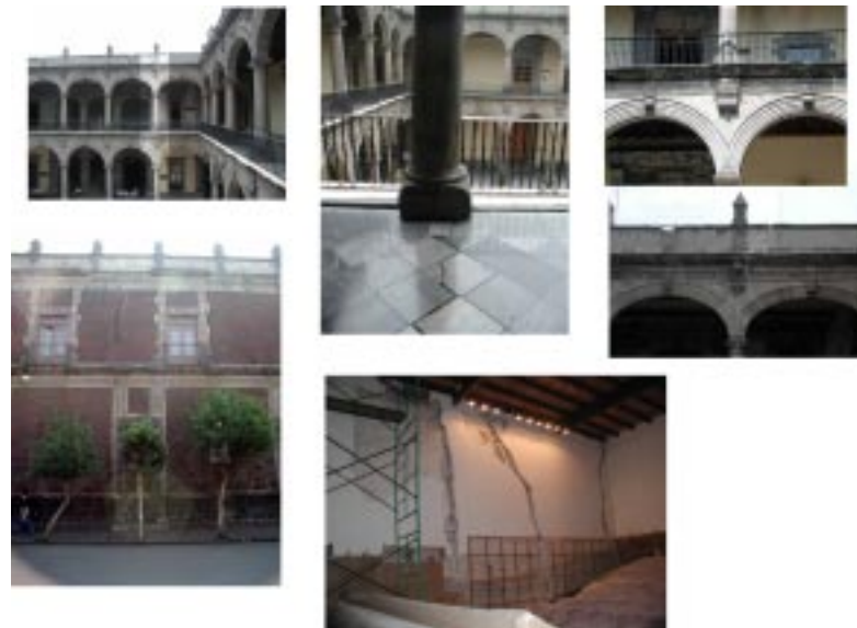
Mecanismo general de agrietamiento en la estructura en la Antigua Escuela de Medicina
