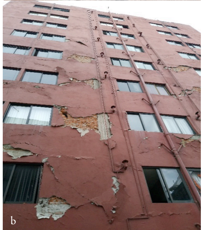
Figura 1 Daños en edificios CDMX, 19 de septiembre de 2017 a. Daño estructural. b. Daño no estructural
