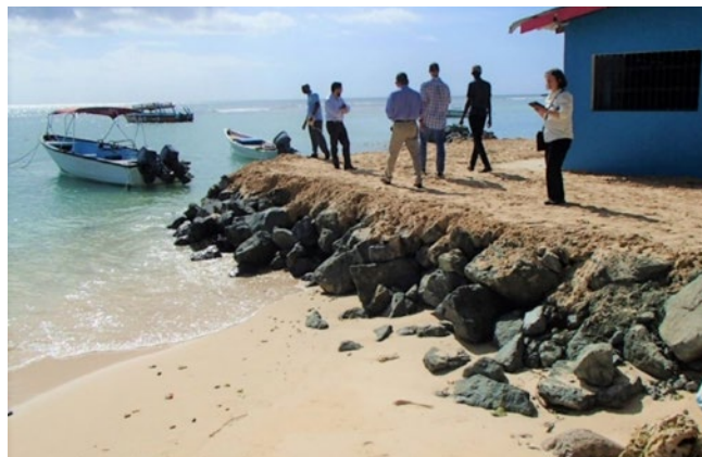
Figura 1. Erosión costera y mala planeación de infraestructura turística en Pigeon Point, Trinidad y Tobago
