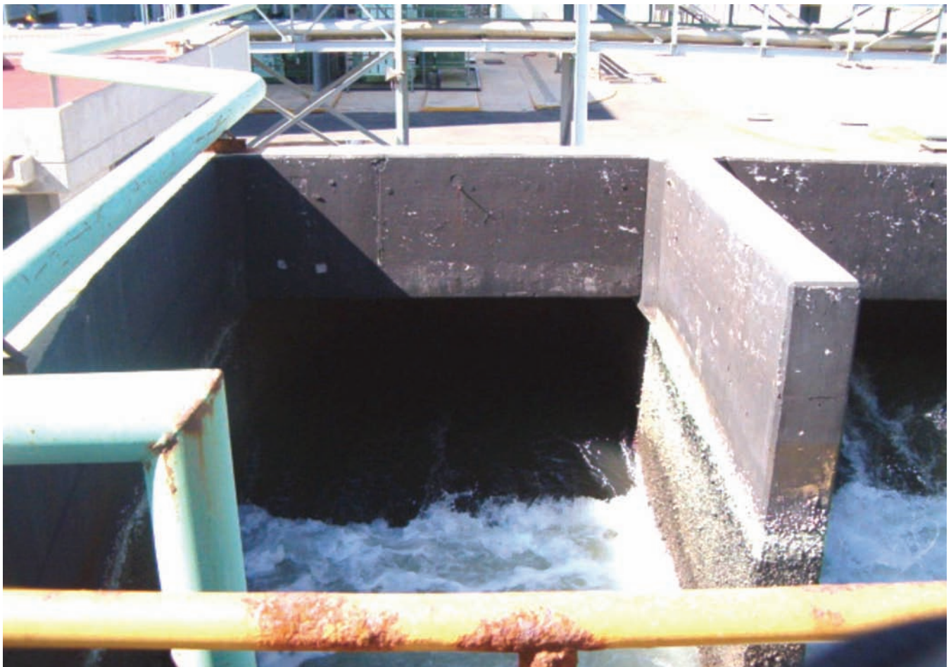
Fotografía de la caja de sello donde empieza el tramo a gravedad
