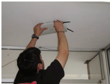
Instalación de puntos de acceso inalámbrico
