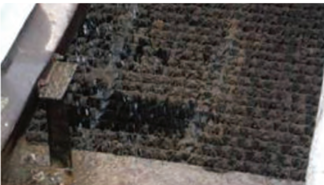
Lodo depositado en las placas del sedimentador
