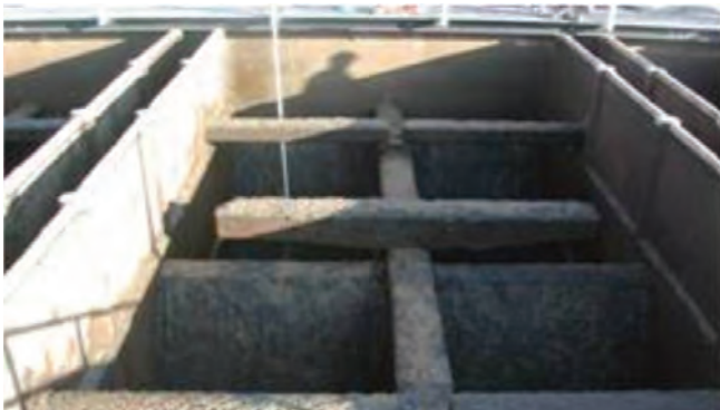
Sección del sedimentador donde se muestran las paredes con lodos adheridos
