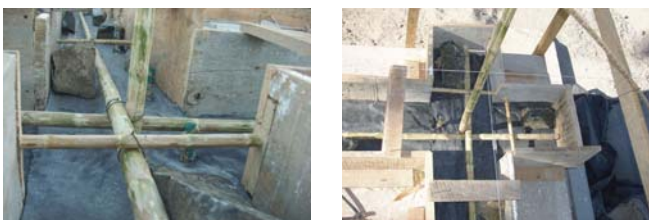
Disposición general del refuerzo de la cimentación y del anclaje de las varas que servirán de refuerzo para los muros de adobe
