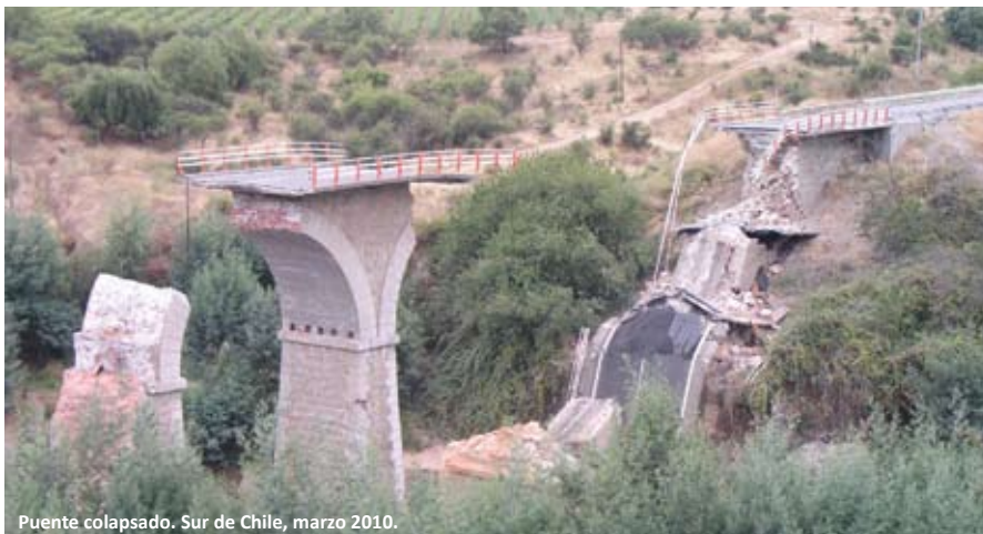
Puente colapsado. Sur de Chile, marzo 2010.
